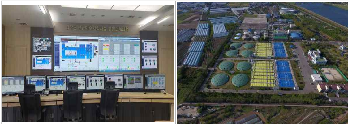
(고창군) 공공하수처리시설 통합관제센터
